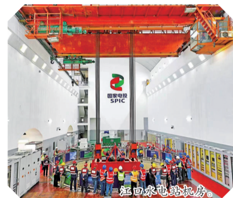
江口水电站机房。
